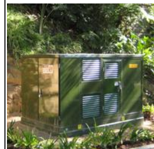
AUSGRID Kiosk substation
